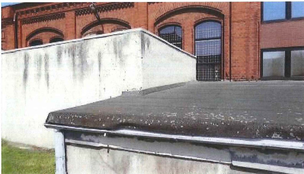
Zdj. nr 3 Klatka schodowa, elewacja południowa i wschodnia. Zbyt krótkie i nieszczelne blacharki (brak łączów między arkuszami blach) powodują zaciekanie wód opadowych na ściany czego skutkiem są odspojenia tynków i kolonie glonów w miejscach zacieków. Tynk cem-wap. na elewacji spękany. Widoczne spękania tynków na poziomie stropodachu klatki schodowej. Pokrycie dachowe z papy nie posiada prawidłowych obróbek blacharskich na ścianach – brak obróbek i nieszczelne połączenie między ścianą a dachem.
