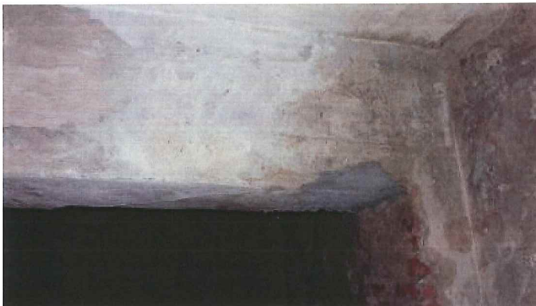
Zdj. nr 21 Magazyn opału. Południowy koniec podciągu. Uzupełniony ubytek od spodu podciągu w miejscu otuliny, która odpadła. Wysolenia na podciągu świadczą o złej izolacji przeciwwodnej na stropie.
