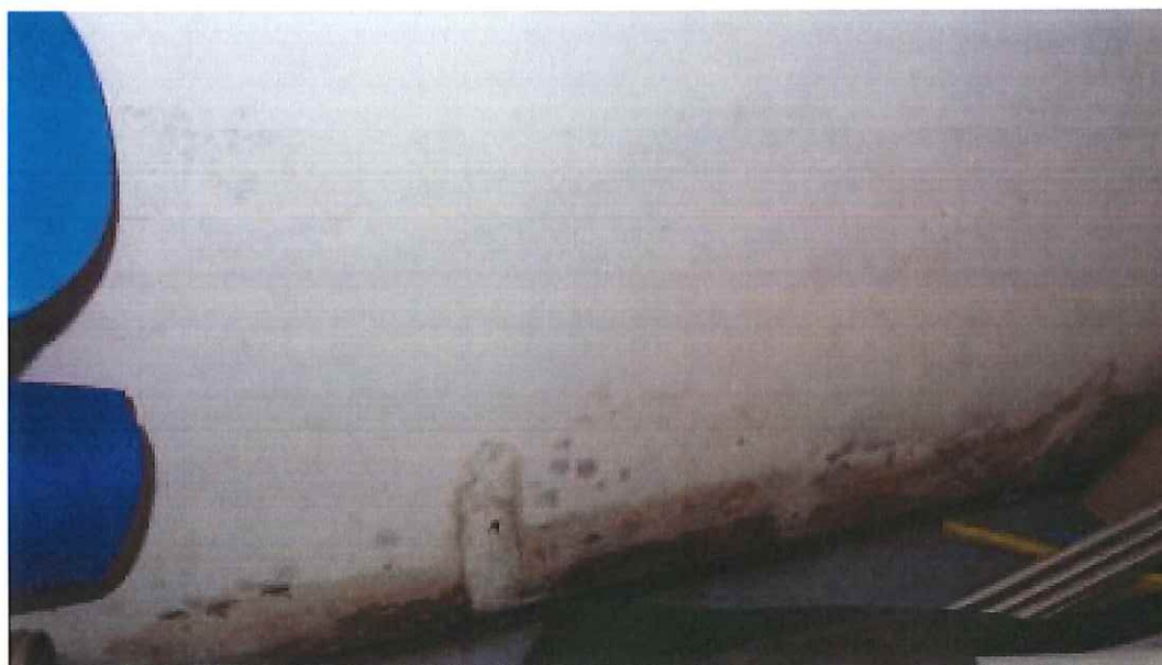
Zdj. nr 28 Siłownia, ściana południowa. Podciąganie wody na płytach GK. Po opadach deszczu, woda przesącza się przez ścianę południową.
