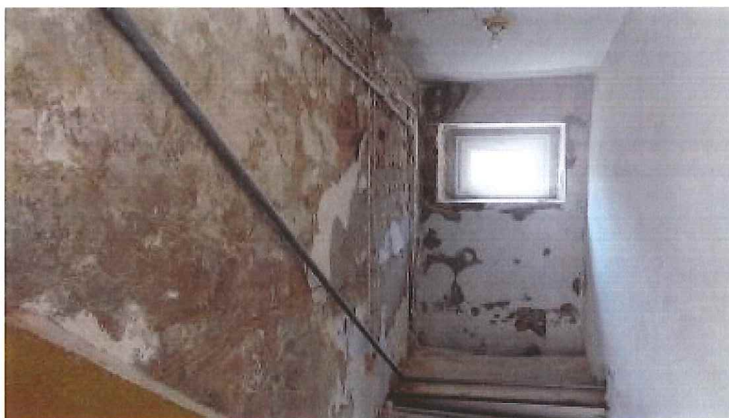
Zdj. nr 26 Ściana wewnętrzna zachodnia między siłownią a klatką prowadzącą na poziom terenu. Odpadające tynki nad schodami.
