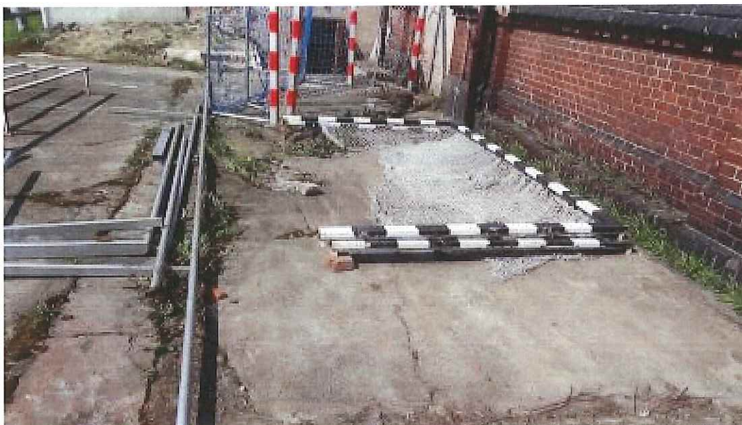
Zdj. nr 9 Między południową elewacją hali a ścianą magazynu opału znajduje się betonowa zlewnia z wpustem podwórzowym. Za nimi przy ścianie hali znajduje się studzienka kanalizacyjna przykryta ażurową kratą. Brak izolacji pod spękaną płytą powoduje zalewanie ścian zarówno hali jak i magazynu opału.
