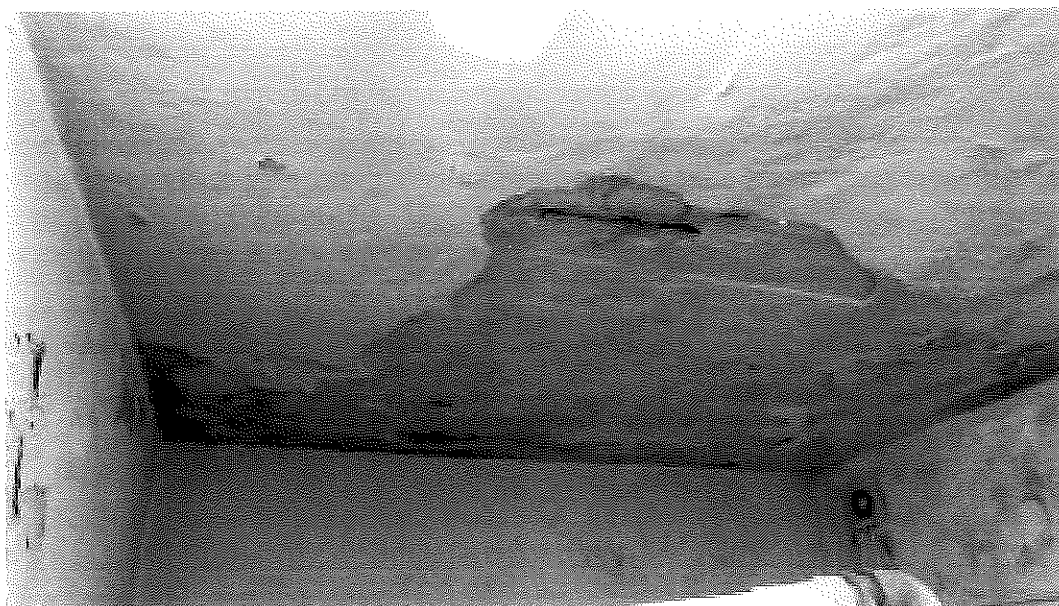
Zdj. nr 24 Wymiennikownia, sufit. Warstwy tynkarskie i malarskie odpadły od żelbetowego stropu na skutek przemakania konstrukcji .
