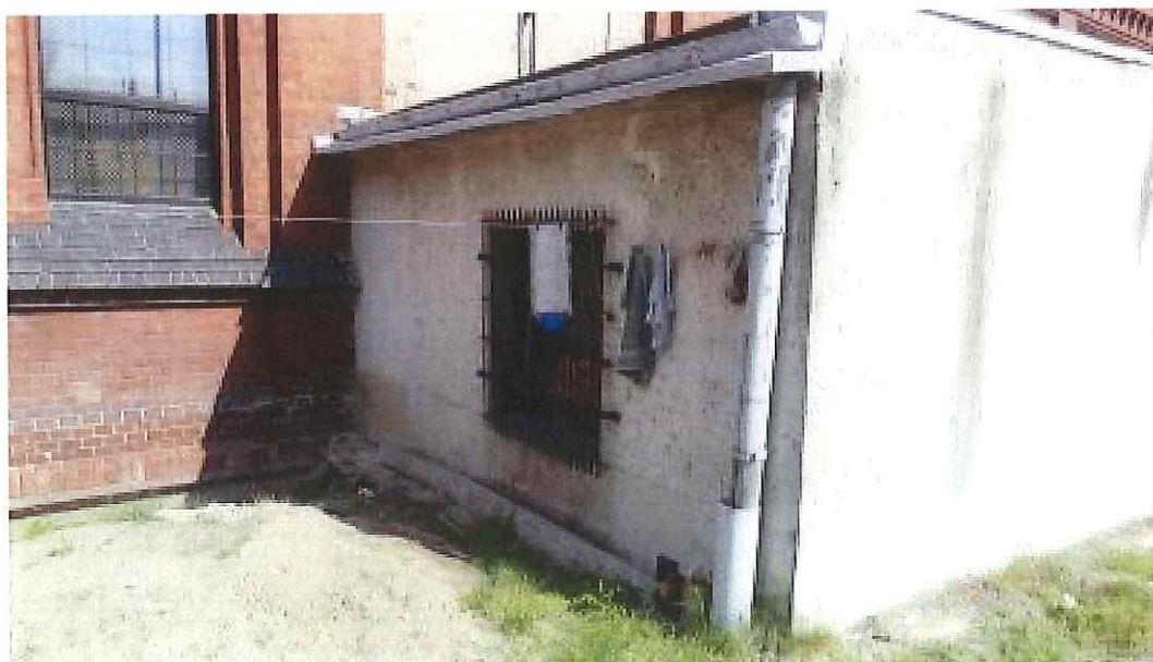
Zdj. nr 2 Klatka schodowa elewacja zachodnia. Widoczne zacieki na tynku poniżej nieszczelnych obróbek blacharskich. Tynk gruby cem-wap. miejscowo odspojony. Przy budynku opaska betonowa.
