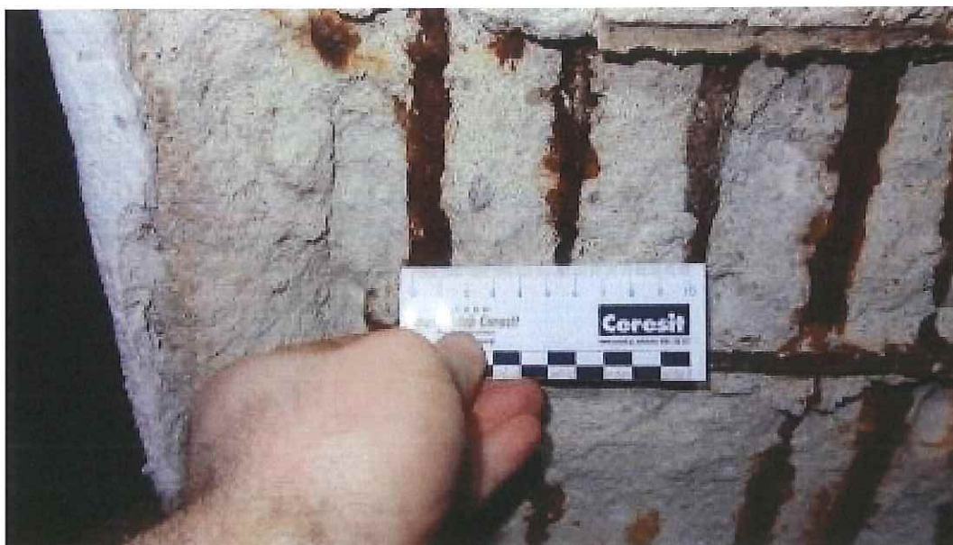
Zdj. nr 17 Magazyn opału. Podciąg żelbetowy stropu. Rozstaw prętów 5 cm. 9 prętów stanowi zbrojenie dolne podciagu. Średnica prętów obecna 12 mm. Pręty miały pierwotnie średnicę 16 mm, 4 mm średnicy ubyło na skutek korozji.
