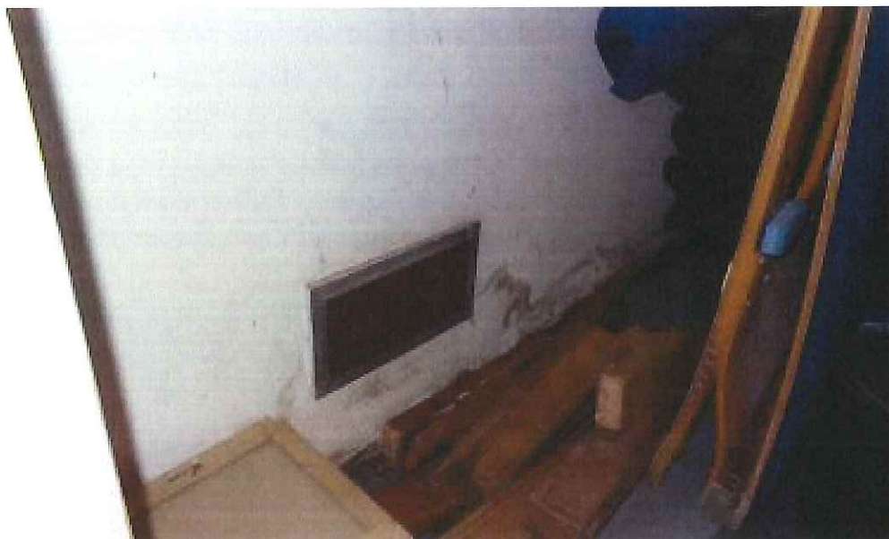
Zdj. nr 27 Siłownia. Kratka nawiewna 20 cm nad podłogą. Od dołu widać podciąganie kapilarne wody w płytach gipsowo-kartonowych.
