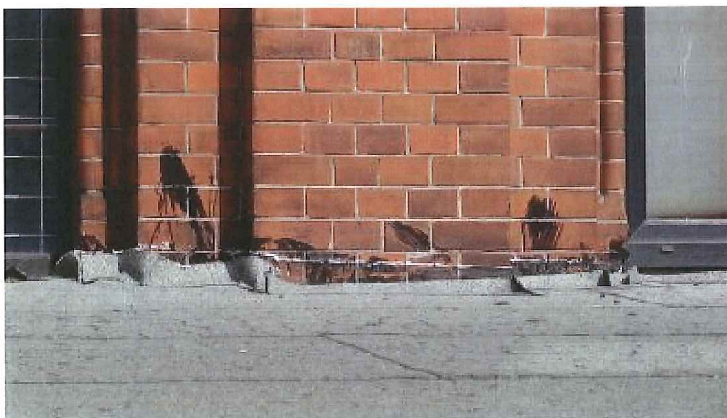
Zdj. nr 4 Połączenie dachu nad siłownią ze ścianą hali. Wywinięta papa na ścianę, odkleiła się od niej, na skutek czego następuje migracja wody do stropu pod papą.
