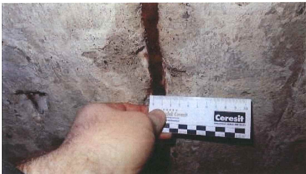
Zdj. nr 19 Płyta stropowa w miejscu największej korozji prętów. Cienka warstwa otuliny – 5-10 mm, spowodowała, że pręty dolne płyty żelbetowej są widoczne jako rdzawe pasy. Korozja prętów spowodowała zmniejszenie średnicy prętów z 16 do 12 mm. Rozstaw zbrojenia dolnego płyty wynosi 15 cm.
