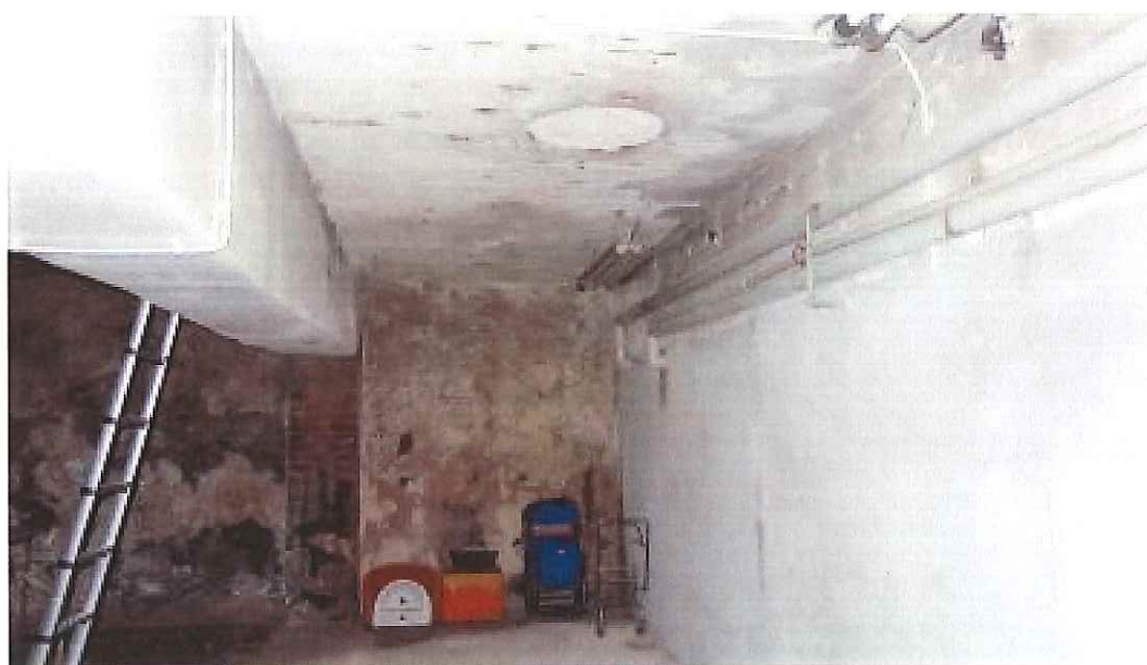
Zdj. nr 20 Na wprost ściana południowa magazynu opału, po prawej ściana działowa wygradzająca z magazynu opału, wymiennikownię ciepła. Na wszystkich ścianach widoczne jest podciąganie kapilarne wody od gruntu.
