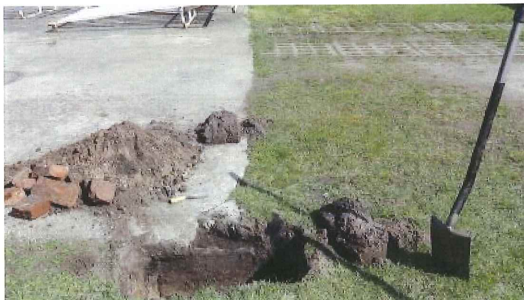
Zdj. nr 12 Odkrywka wykonana na południowo-wschodnim narożniku magazynu opału. Betonowa płyta osłonowa na poziomej izolacji z papy bitumicznej. Brak izolacji pionowej po zewnętrznej stronie ściany.
