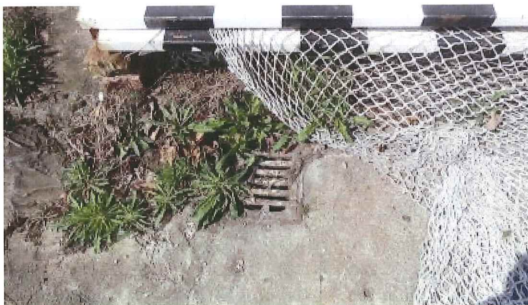
Zdj. nr 10 Wpust podwórzowy między południową elewacją hali a ścianą magazynu opału. Uszkodzona nieuszczelna powierzchnia betonu.
