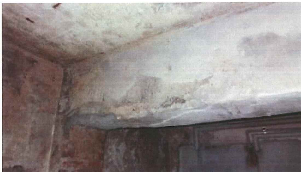
Zdj. nr 15 Skład opału – jeden z 2 podciągów podpierających strop magazynu. Tynki cem-wap. łuszczą się. Brak skutecznej izolacji poziomej stropu powoduje zamakanie jego żelbetowej konstrukcji. Dolna otulina zbrojenia na skutek stałego zawilgocenia i przemarzania odpadła i została uzupełniona. Na podciągach nie widać żadnych rys ani nadmiernych ugięć.
