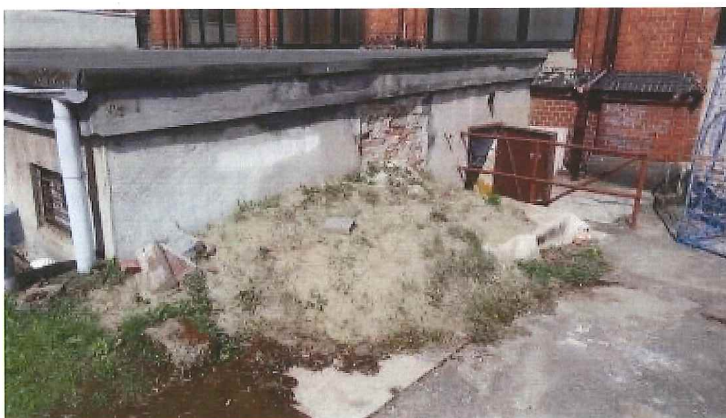
Zdj. nr 6 Śląska 51. Elewacja wschodnia od klatki schodowej – wyjście na poziom terenu. Duże ubytki tynku na elewacji, pod górą piasku znajduje się szyb windy lub zaślepiiony świetlik. Lastryko odparzone od ściany, na wysokości stropu widoczne zalania. Brak obróbek blacharskich na obrzeżach dachu.
