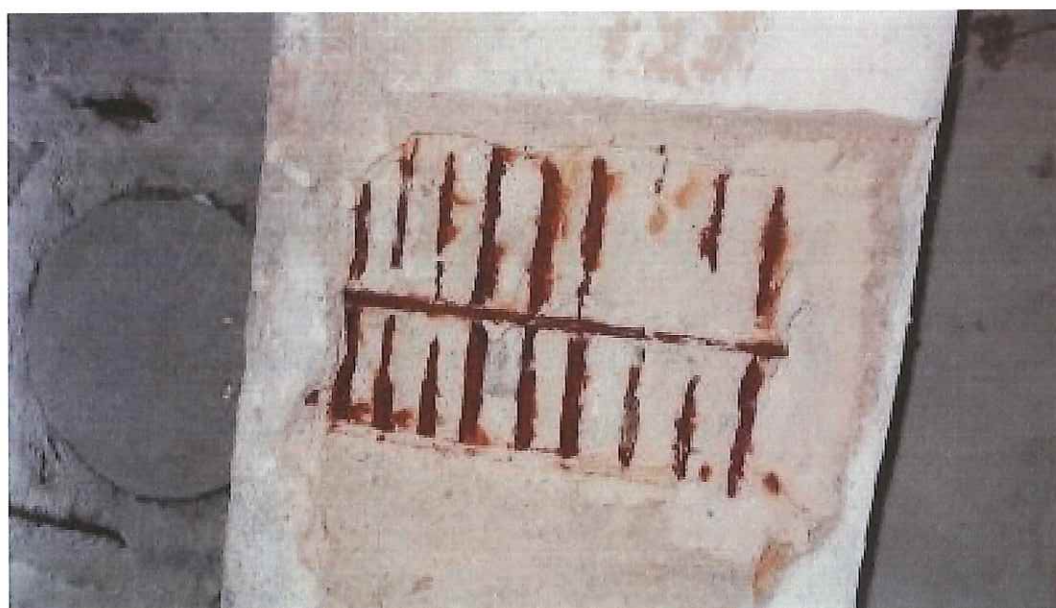
Zdj. nr 16 Odkrywka zbrojenia na podciągu stropowym. Otulina bardzo słabo przylega do zbrojenia. Widoczna korozja wszystkich prętów podciągu. Beton o jasnej barwie i niskiej klasie wytrzymałości na ściskanie.
