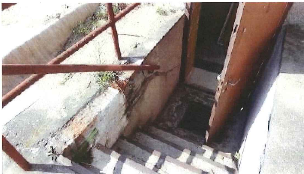
Zdj. nr 7 Śląska 51. Elewacja wschodnia klatki schodowej. Schody do klatki schodowej. Uszkodzenia wypraw lastriko, zerodowana cegła bocznych murów, schody betonowe z kątownnikami stalowymi.
